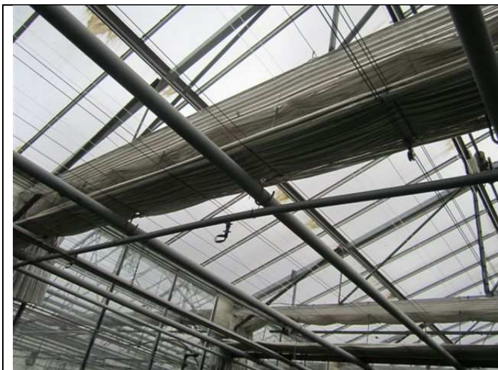
Système automatique de chauffage (tuyaux) et de chaleur (fermeture de rideaux)
